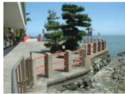
〈28〉ガードパイプ 3
