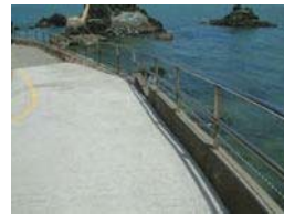
〈28〉ガードパイプ 4
