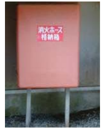
〈47〉消火ホース格納箱
