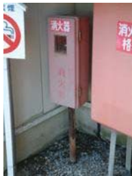
〈48〉消火器格納箱
