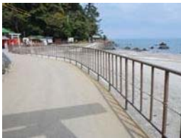
〈28〉ガードパイプ 2
